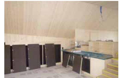
Ausbaulemente in Dreischichtplatten, Ausstreichen der Einbau- und Küchenschränke mit der Farbe des geplanten Linolbodens.
