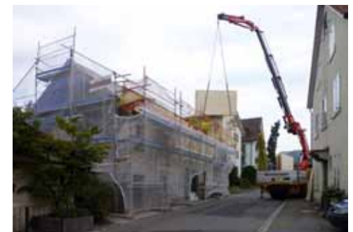
Bilder links: Holzkonstruktion der Gaube; Bilder oben: Gebäude nach dem Rückbau, Aufbau der Sparrenlage über dem N 1 und der Kniestöcke, Neuer Dachstuhl, Anlieferung Dreischichtplatten.
